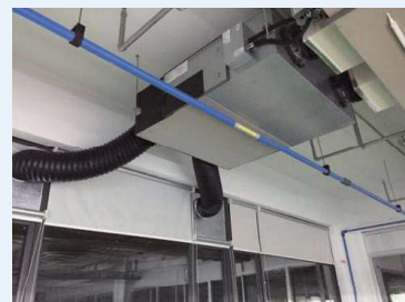
新风设备保证室内空气质量
